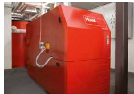
Ideal bei engen Platzverhältnissen: Heizungssanierung mit dem UltraOil® (110) in einem Mehrfamilienhaus.
